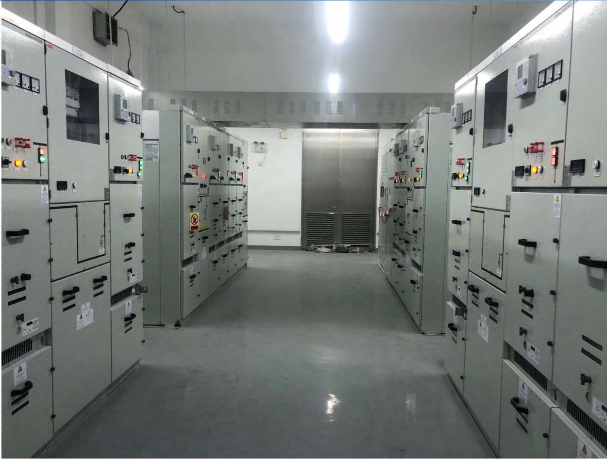
Оборудование береговых электростанций
