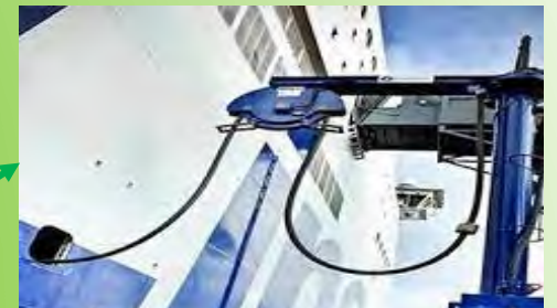
为拖船和港口船只提供岸电。
